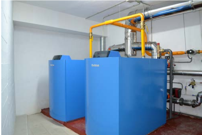
Dos calderas GB402 en cascada
